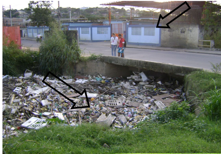
Figura 14 - Acúmulo de lixo sob a ponte, nas proximidades da Escola Municipal Valéria de Mattos Fontes. Foto: Felipe Saraiva
