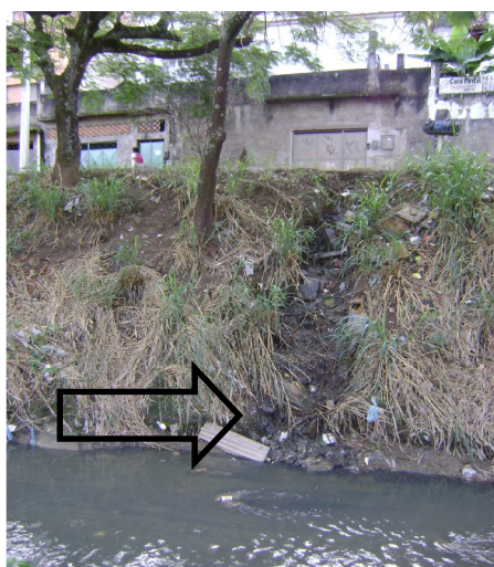
Figura 12 – A inclinação de algumas árvores surge como sinal da erosão, causada pelo lançamento de esgoto.
